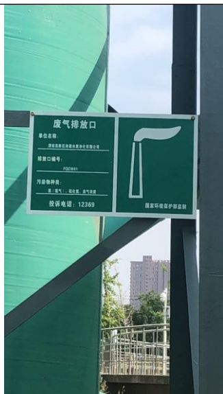
除臭设备排气筒
