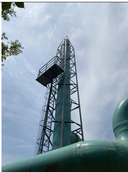
除臭设备排气筒
