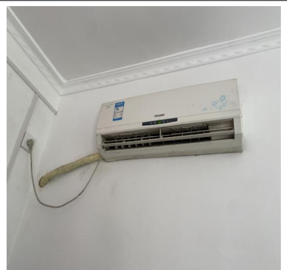
在线监测站房空调
