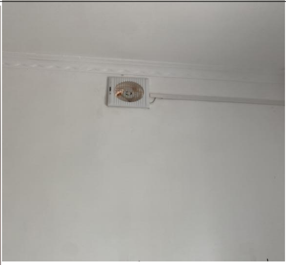
在线监测站房通风设施
