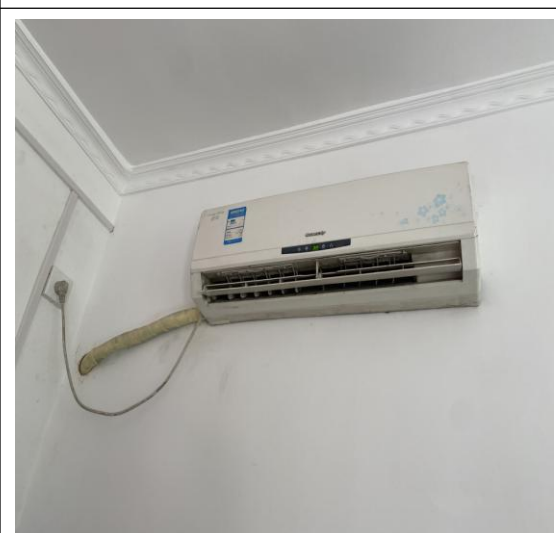
在线监测站房空调
