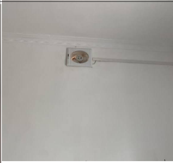
在线监测站房通风设施
