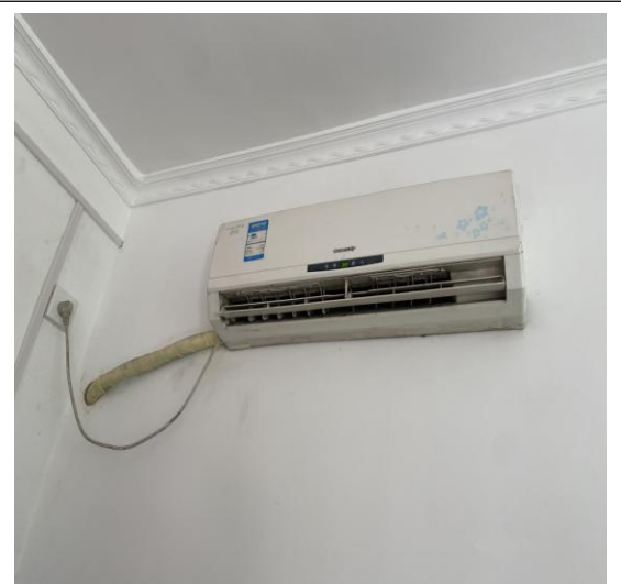
在线监测站房空调
