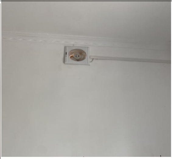
在线监测站房通风设施
