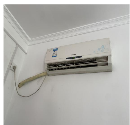
在线监测站房空调
