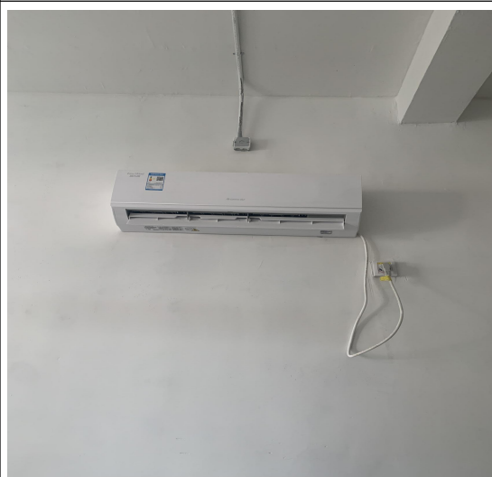
在线监测站房空调
