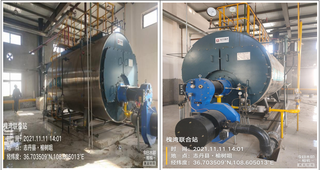
4t/h 燃气锅炉
