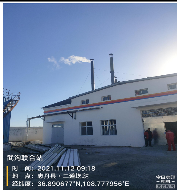
10m 高排气筒
