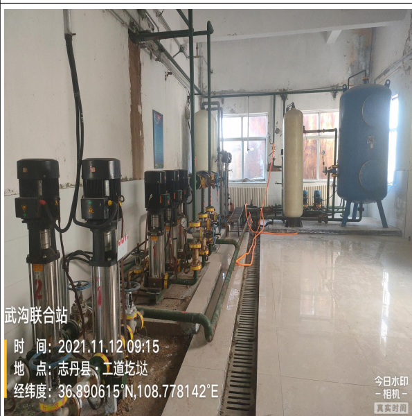
锅炉软化水制备间
