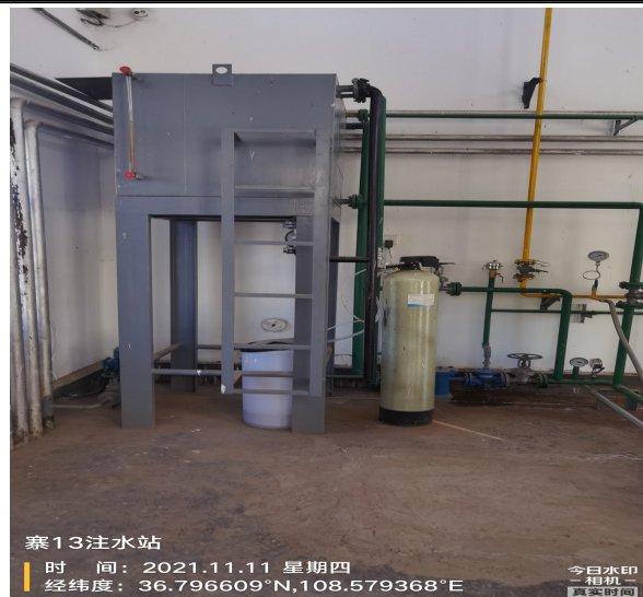
寨 13 注水站软化水制备装置
