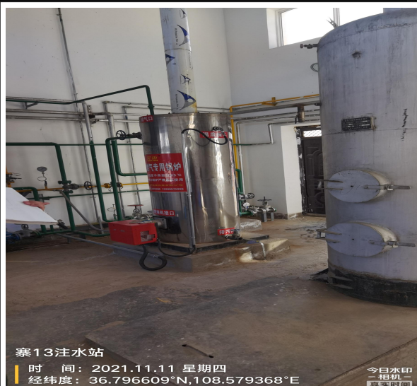
寨 13 注水站燃气锅炉
