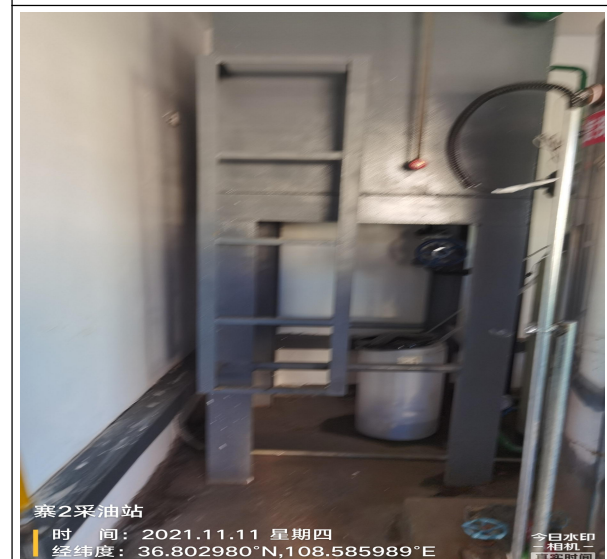
寨2采油站软化水制备装置
