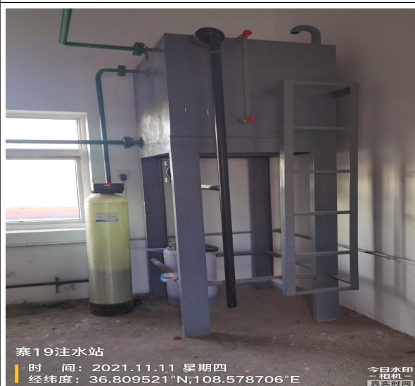
寨 19 注水站软化水制备装置
