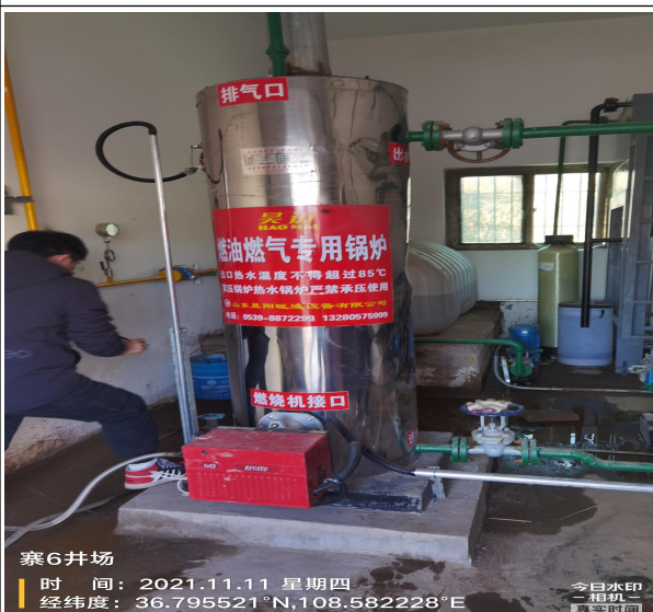
寨6井场燃气锅炉
