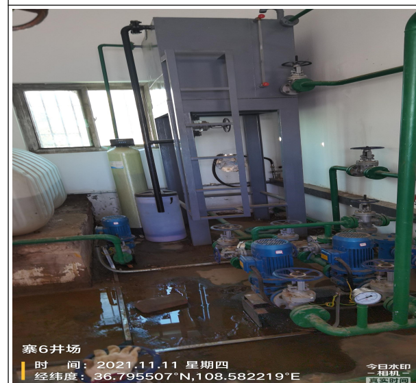
寨6井场软化水制备装置
