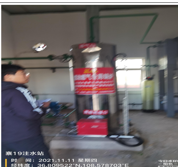
寨 19 注水站燃气锅炉
