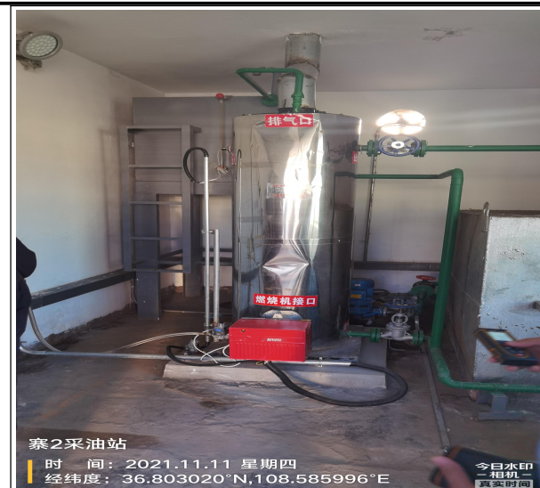
寨2采油站燃气锅炉
