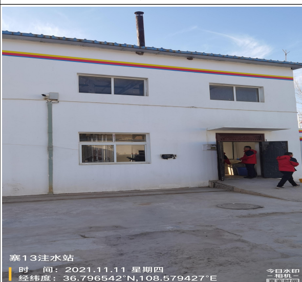
寨 13 注水站锅炉排气筒
