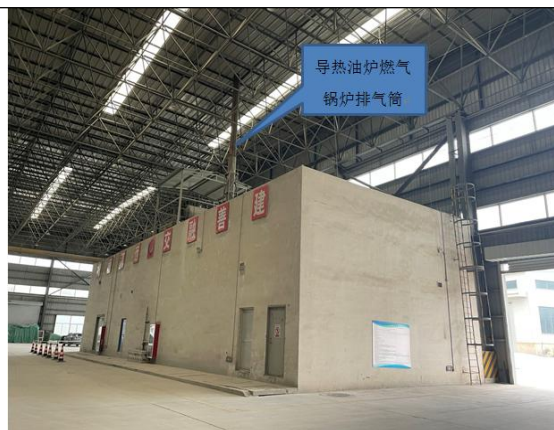
导热油炉燃气锅炉房及排气筒
