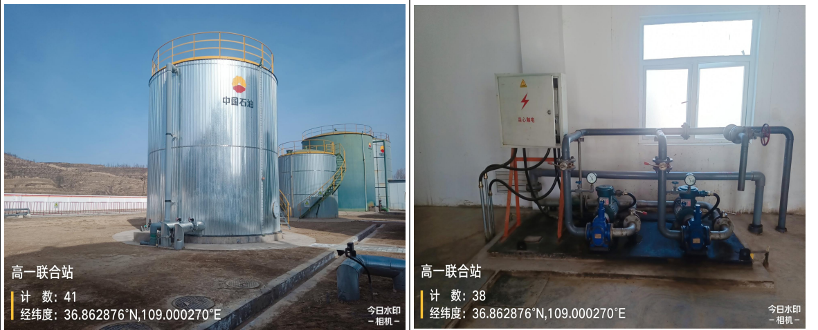
全密闭沉降除油罐
