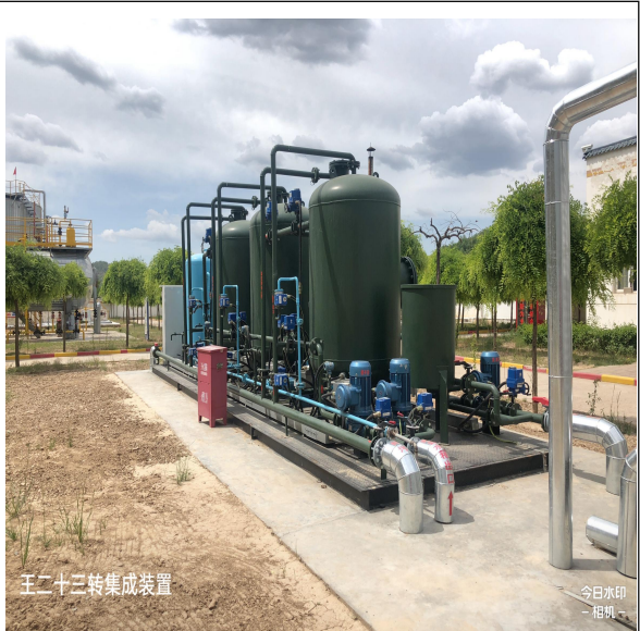
油田采出水处理集成装置
