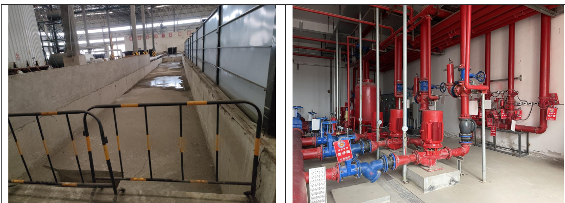
图3-5 事故池及消防设施落实情况
