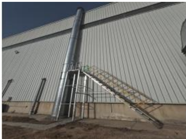
有机废气排放口 (DA006)
