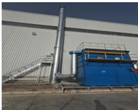
粉尘排放口 (DA007)
