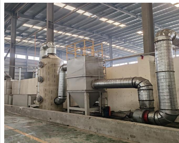
废气治理措施
