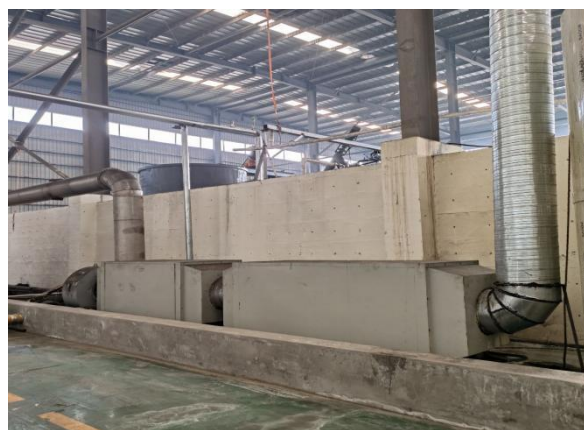
废气治理措施
